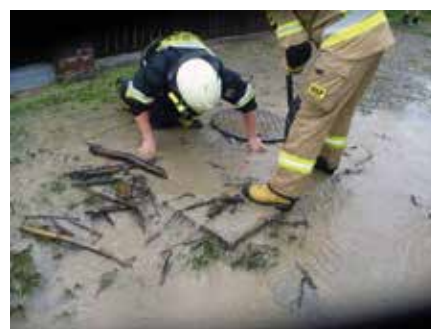
13.07.23-Czchów zatkany ulewą przepust
