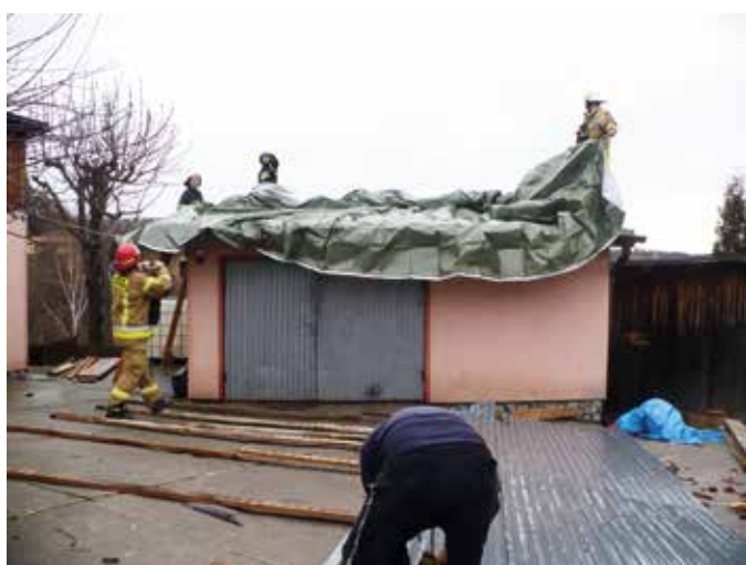
17.02.22-Wytryszczka zerwany dach
