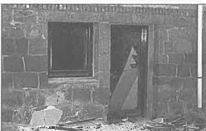
19 maja 2011 r., Czchów - wybuch pieca w kotłowni budynku mieszkalnego
